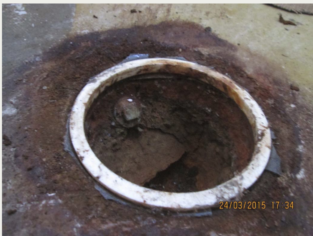
Figur 2. Rost på brunnfläns.
